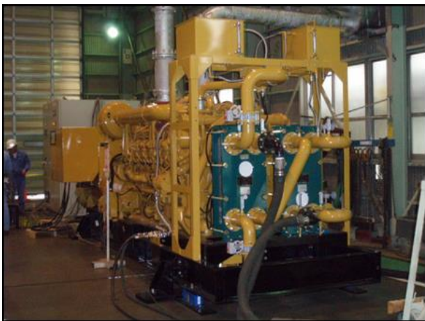
6600V/2000kVA 負荷試験
